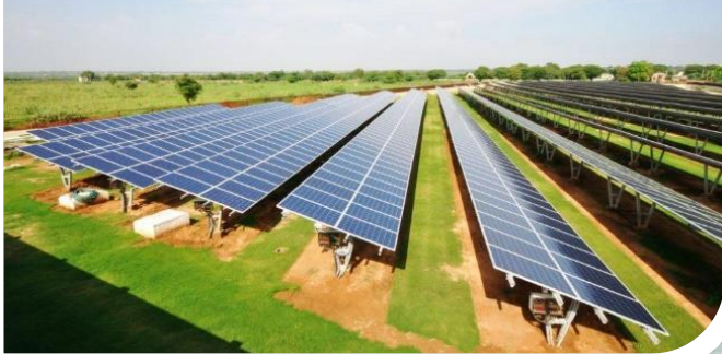
1 MW Solar Plant, PDEU
